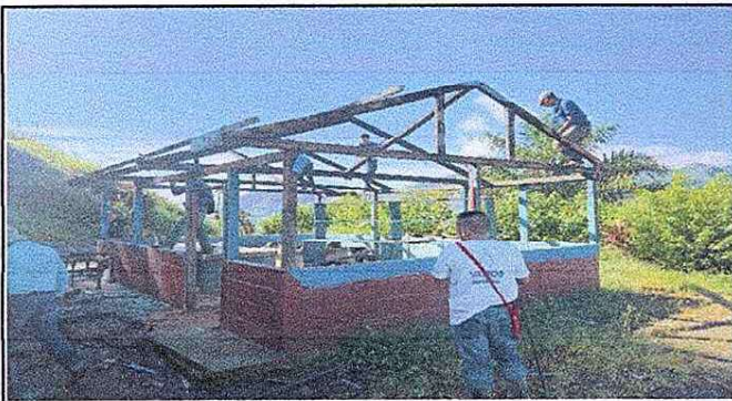
Se obserba cambio de las costaneras de la cocina
